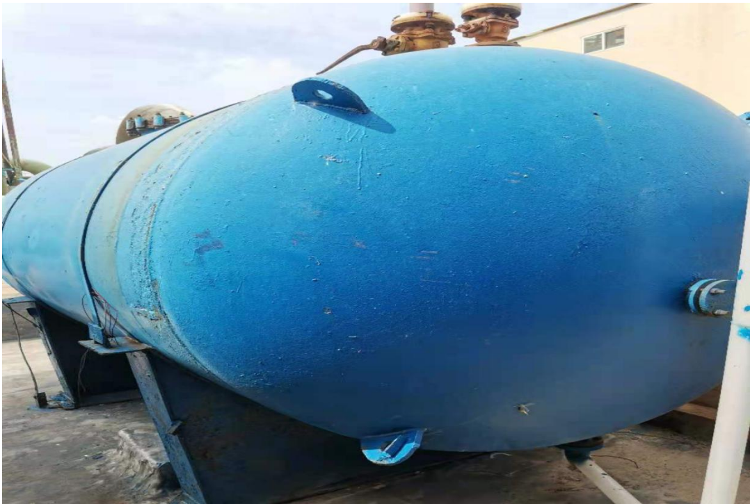
现场发现应注册而未注册的压力容器
