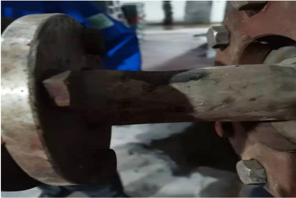
现场发现设备接口处存在的安全隐患
